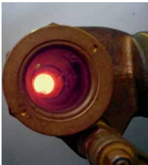
Blick in die Brennkammer, wo die Wärme zur Elektrizitätsgewinnung entsteht
